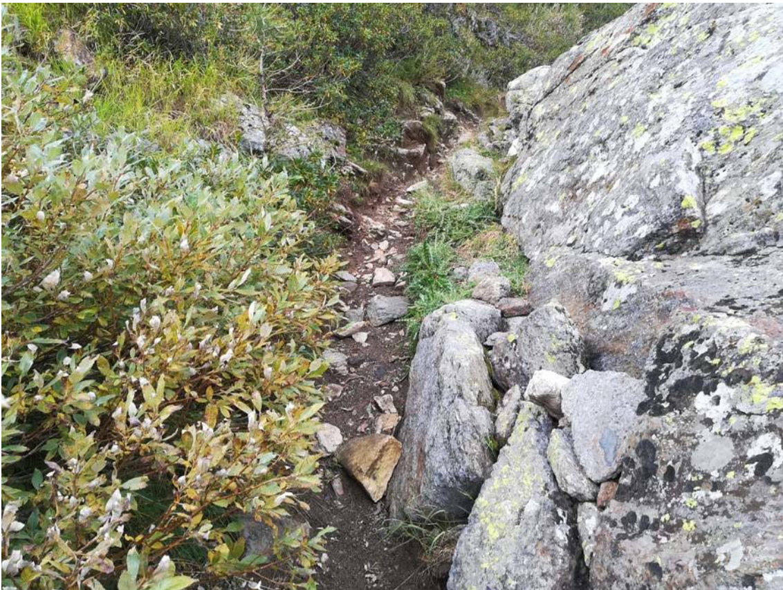
Foto 36: Intervento PT07. Trincea dal fondo roccioso da regolarizzare con posa di una pavimentazione grossolana in pietrame a riempire gli spazi vuoti
