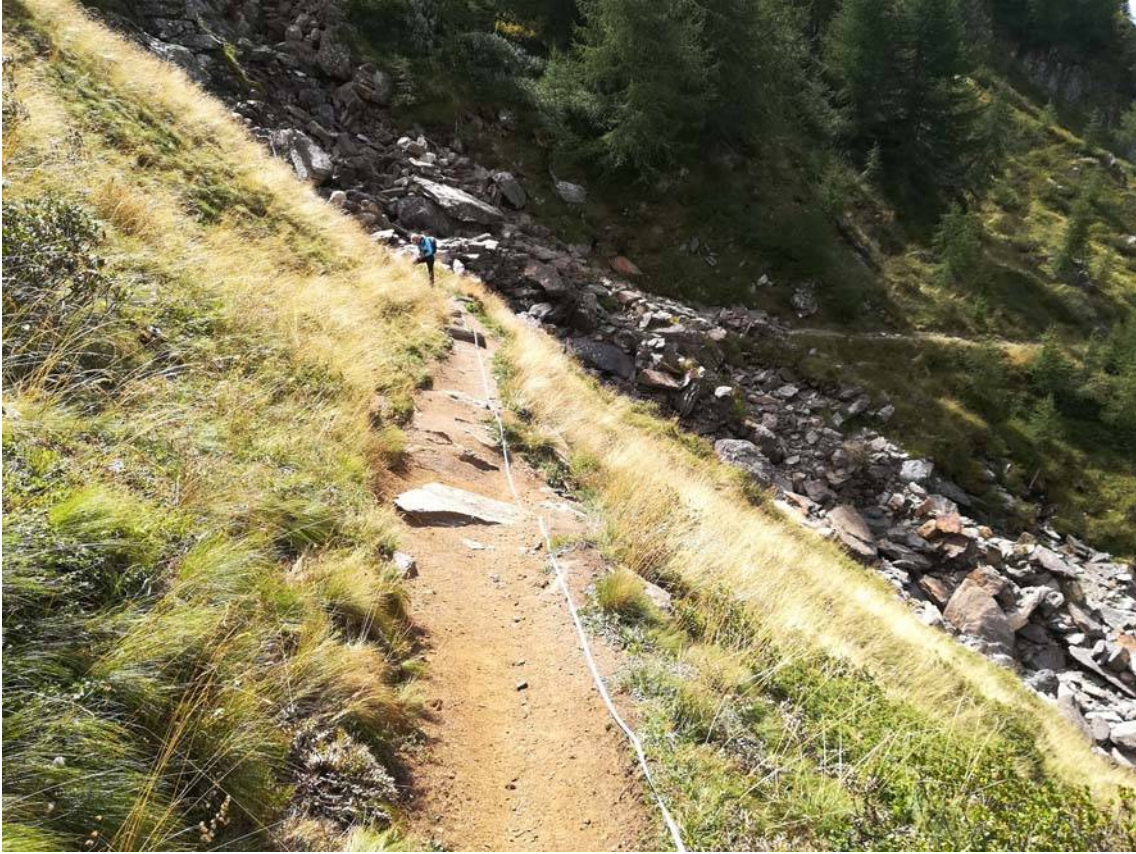
Foto 12: Intervento 12. Tratto a mezza costa a monte di un corso d'acqua che mostra segni di cedimento del lato di valle
