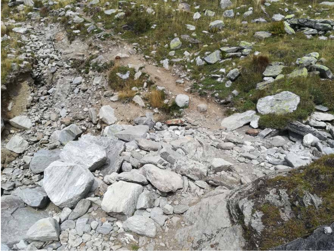
Foto 32: Intervento PT03. Guado da ricostruire su Rio della Satta comprensivo di doppia fila di scogliera a protezione della sponda destra in erosione
