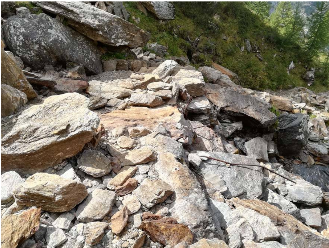
Foto 35: Intervento PT06. Guado da rifare su affluente del Rio della Satta
