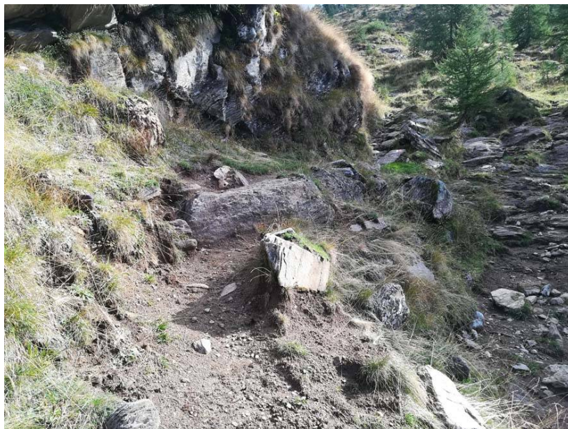
Foto 43: Intervento PT13. Alto gradino rocciosa da superare tramite una rampa in pietrame
