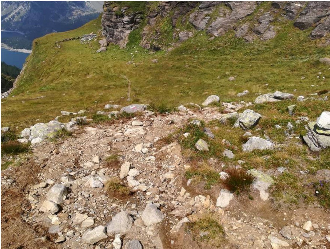
Foto 3: intervento lineare 2: sentiero ripido molto dissestato
