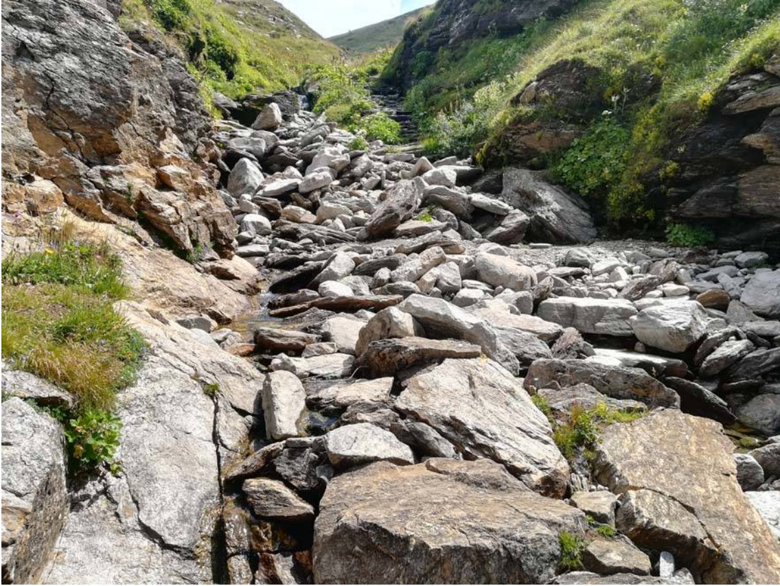
Foto 6a: intervento lineare 6: tratto particolarmente dissestato lungo il Rio della Valle
