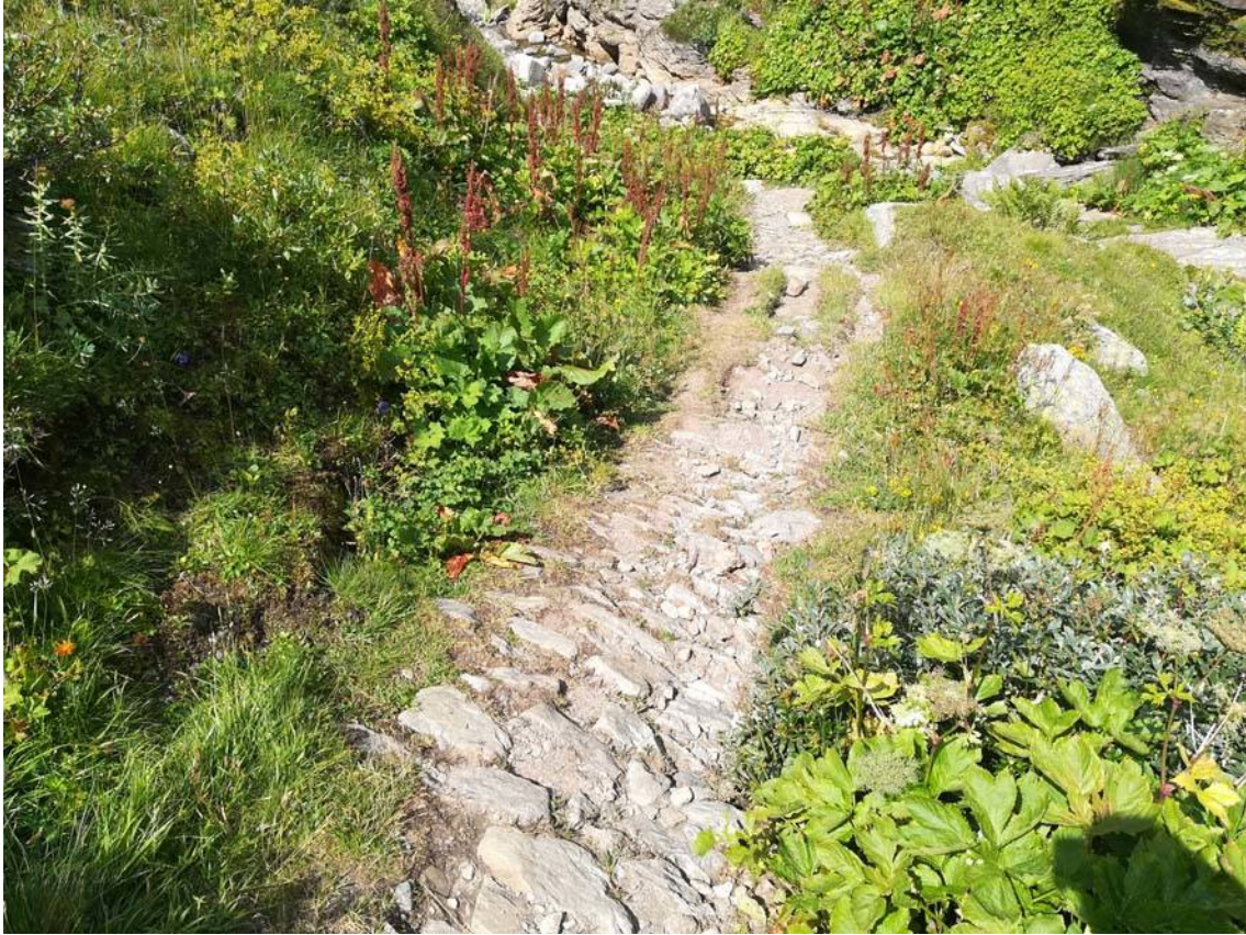
Foto 33: Intervento PT04. Tratto di lastricato esistente da completare nei tratti deteriorati
